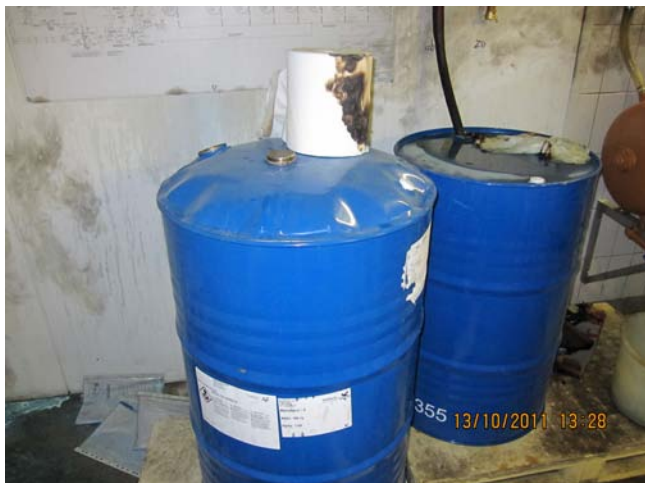
Umfüllstelle für Kondensat aus der Thermoöl-Anlage nach dem Unfall
