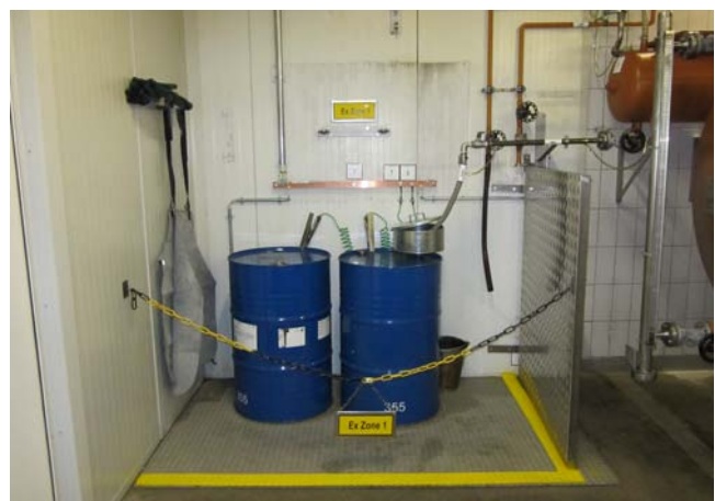
Umfüllstelle für Kondensat aus der Thermoöl-Anlage unter Berücksichtigung des Explosionsschutzes
