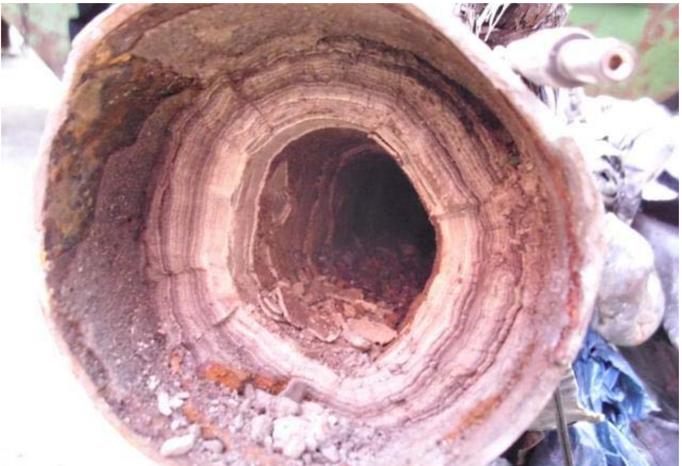
Ablagerungen mit Radium-226 (Spezifische Aktivität 13 Bq/g) an einem Stahlrohr
